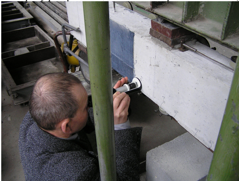
Рис. 2. Візуальне спостереження за утворенням і розвитком тріщин.
